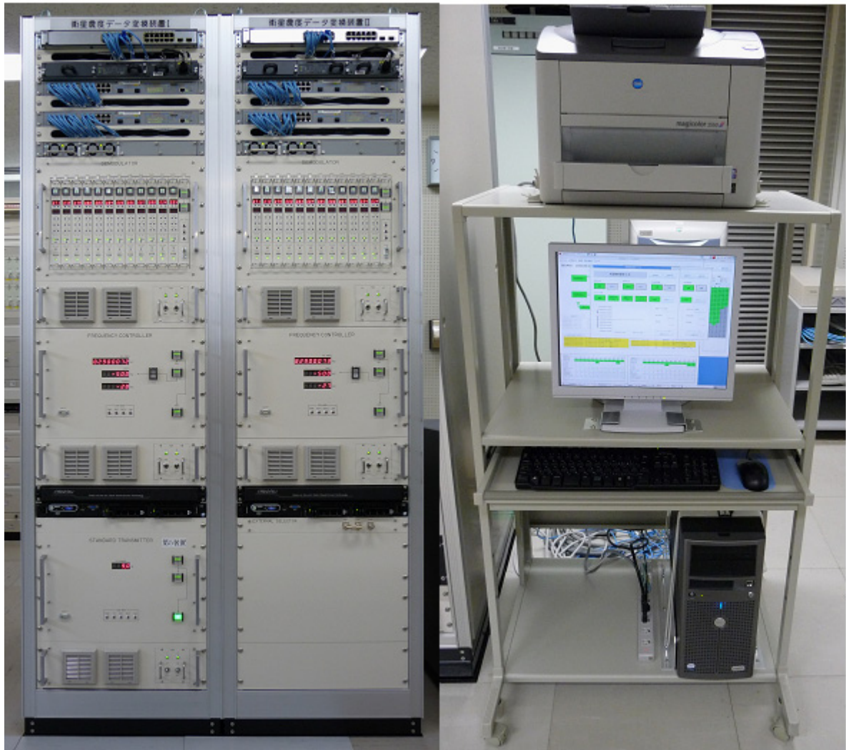
図4_震度データ変換装置架と局監視制御装置
