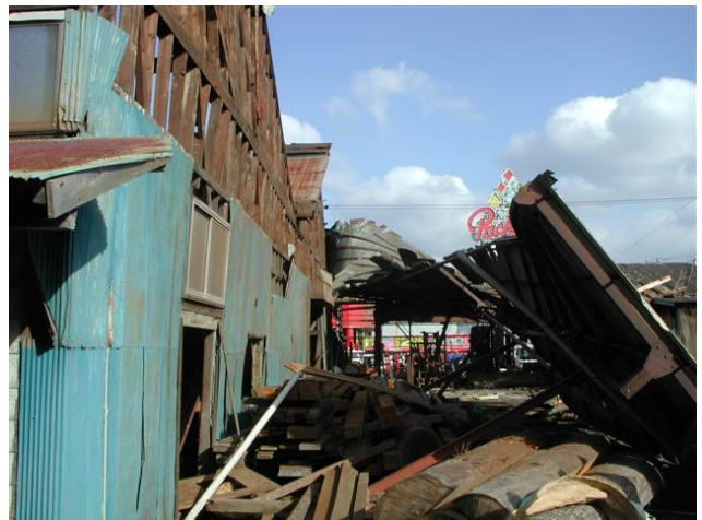
倒壊した屋根
