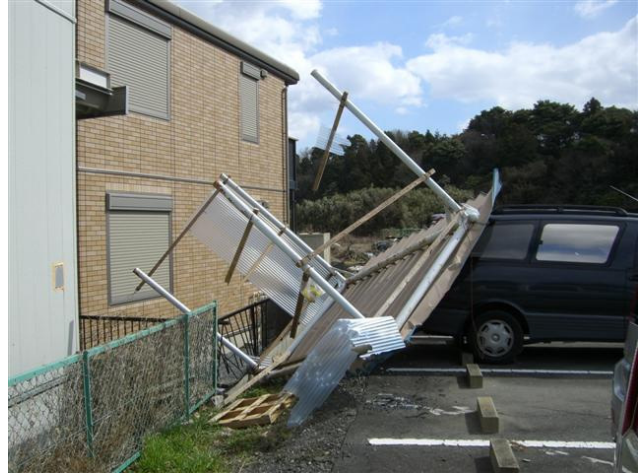
吹き飛ばされた資材置場の屋根と支柱
