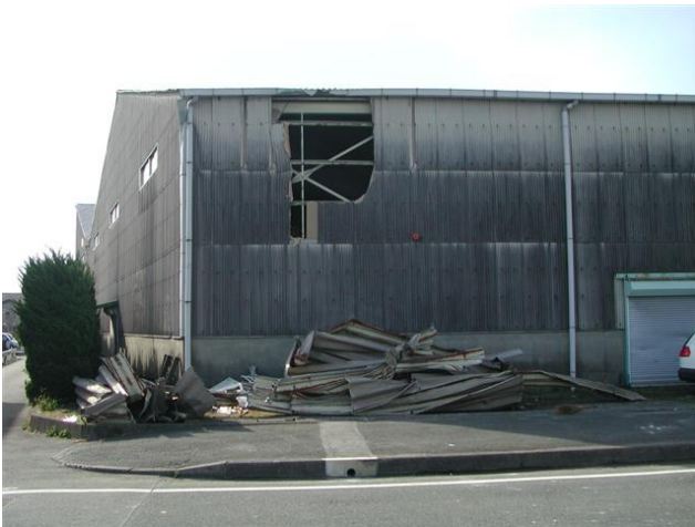
外側に壊れた倉庫壁面
