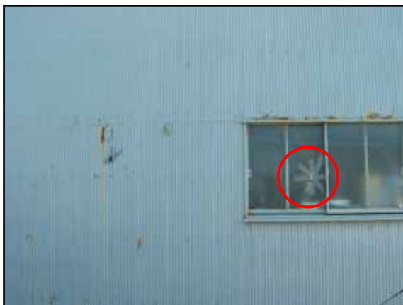
写真 5 飛散物で割れた倉庫の窓ガラス
