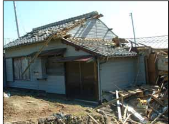
写真 4 屋根が破損した空き家
