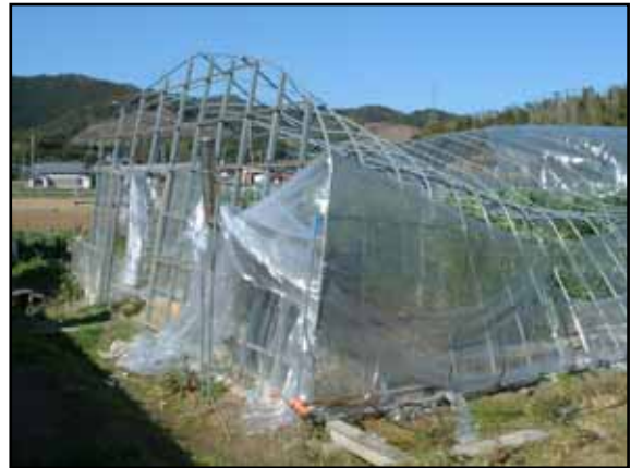
写真 2 押しつぶれたビニールハウス
