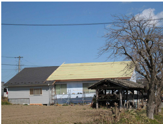
屋根が吹き飛んだ縫製工場
