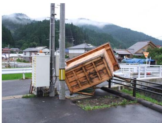
③ ゴミステーション小屋転倒 (南南西から撮影)
