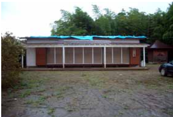
トタン屋根がはがれ北側に落ちた
