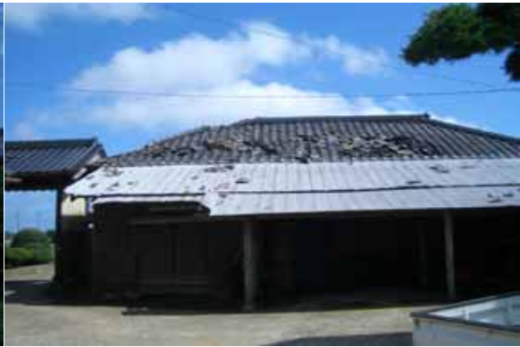
小屋があたり破損した倉庫の屋根
