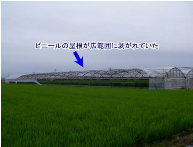
被害ビニールハウス
