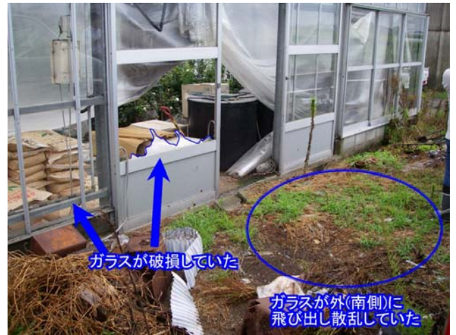
被害ガラスハウス
