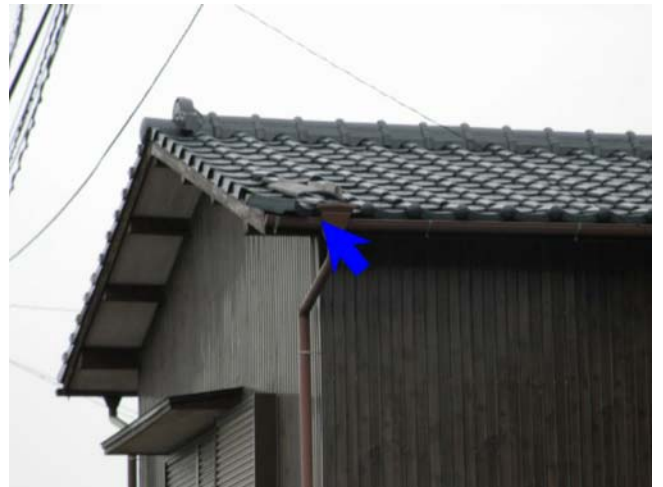
瓦が剥がれていた
