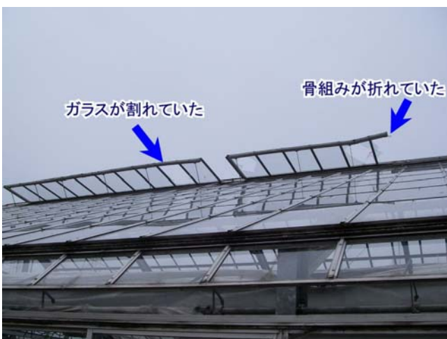
被害ガラスハウス(換気屋根)
