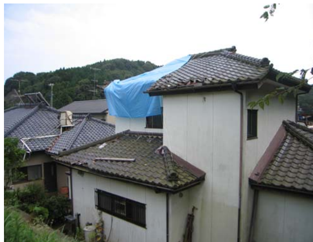
②飛ばされたプレハブ屋根がぶつかって 被害が出た住家
