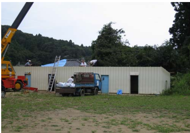
①屋根が飛ばされたプレハブ小屋
