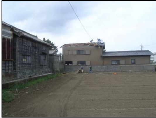
④ 屋根材が剥ぎ取られた家屋。
