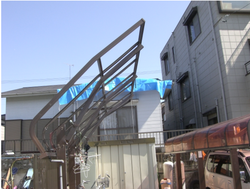
1. 飛ばされ、屋根がなくなったカーポート
