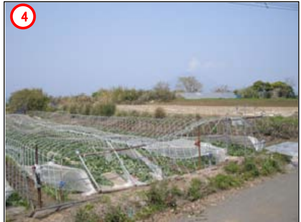
ビニールハウスが北側に倒壊
