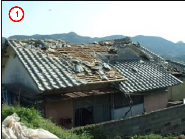
① 南側の瓦が北東方向へ損壊
