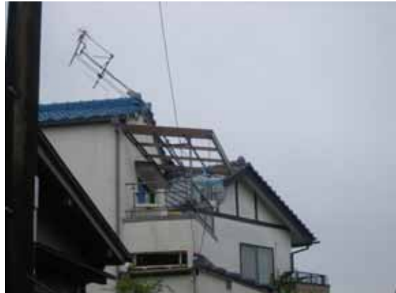
写真の撮影場所 （南方向を撮影） 突風で倒れかかったテレビアンテナ。
