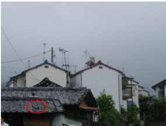
写真の撮影場所 （南東方向を撮影） 屋根瓦が一部損壊した。
