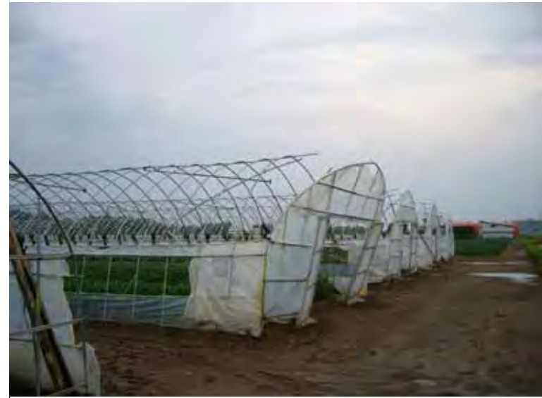
写真5 - 2 ビニールハウスの入り口側破損
