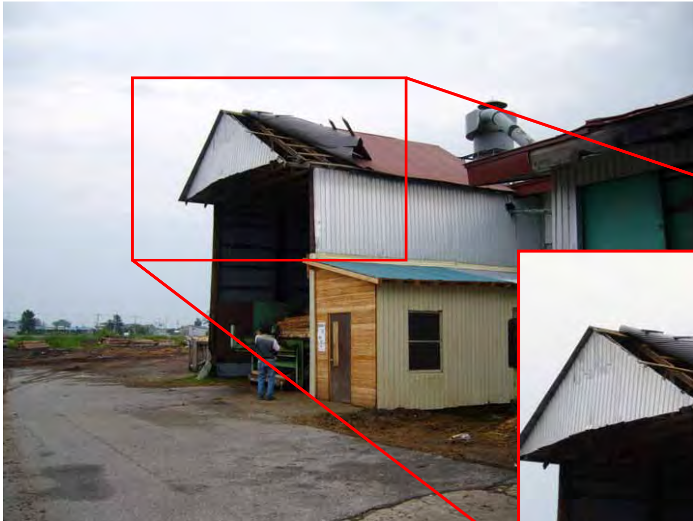
写真4 - 1 南側にトタンが剥離
