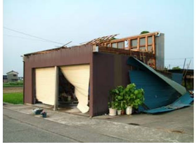
②シャッターが破損しタン屋根がめくれた車庫（南西から撮影）
