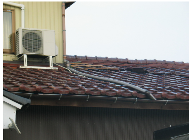
④南側から屋根の上に上がった木杵と、めくれた瓦（西から撮影）
