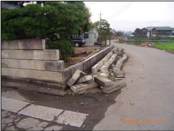
③ 倒れたブロック塀 (南側から撮影) 【太田市】
