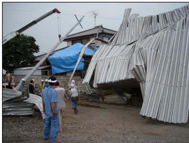
① 飛散したトタン屋根 (電線に引っかかり電柱が倒れている)
