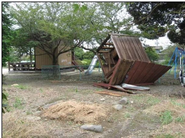
⑥ 転倒した小屋 (西側から撮影) 【足利市】
