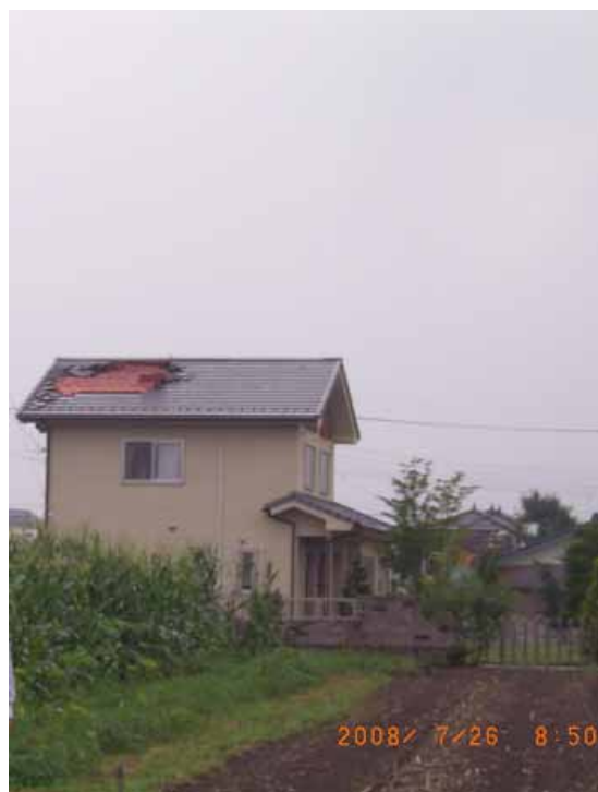
屋根瓦が剥がれた住宅 (北西側から撮影)
