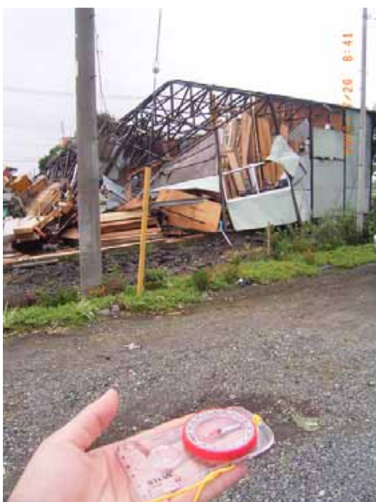
倒壊したプレハブ小屋 (北西側から撮影)
