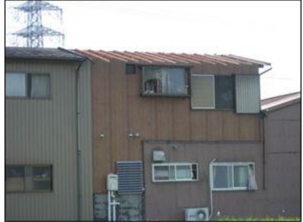
②トタン屋根が飛ばされた住家 (北東側から撮影)
