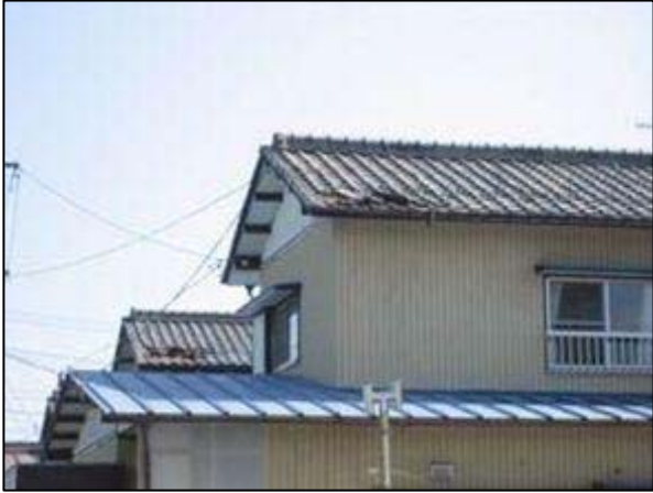
①屋根瓦が剥離している2軒の住家 (北北東側から撮影)
