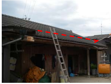
屋根のスレート（約 10m×2m）が飛散（赤い部分）：撮影場所①
