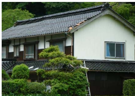
④ 鳥取市青谷町善田 被害があった民家の状況。 2階北面と1階東面の瓦が飛散した。
