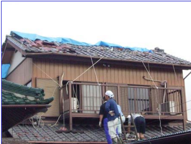
①: 被災家屋を南南東側から撮影 (瓦の飛散)
