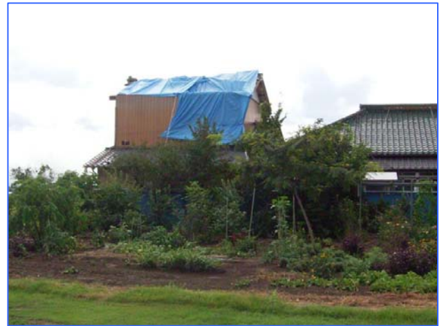
②: 被災家屋を北北西側から撮影 (屋根部大きく損壊)
