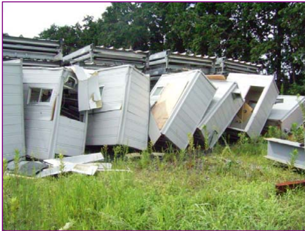
③：被災現場の将棋倒しとなった小型プレハブ
