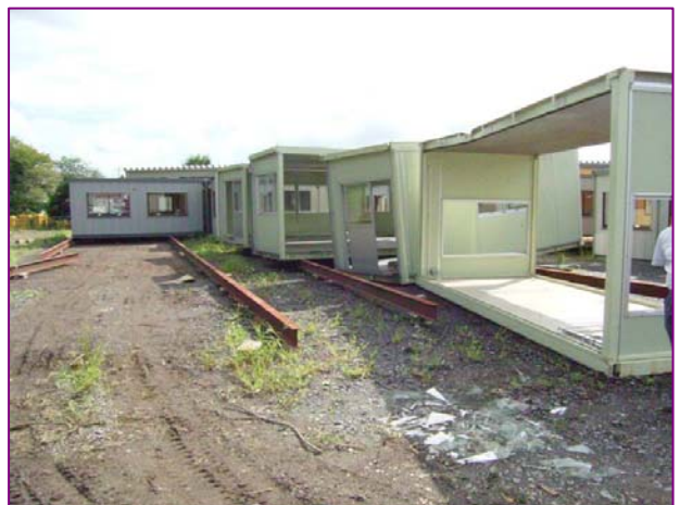
④：被災現場のプレハブ小屋(突風発生前は整然と並んでいたとの証言あり)
