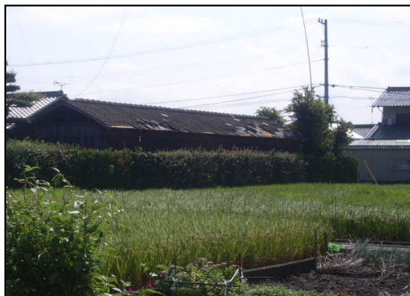
① 仲多度郡多度津町若葉町地区 若葉町地区の数軒の屋根瓦が東方向に飛散
