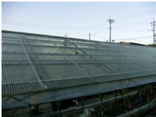
④ハウスの波板の屋根破損 (南東から撮影)
