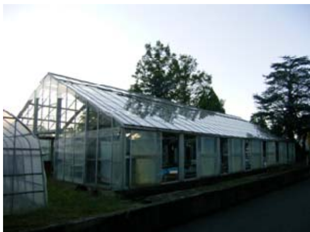
⑤ハウスのガラス屋根破損 (南東から撮影)
