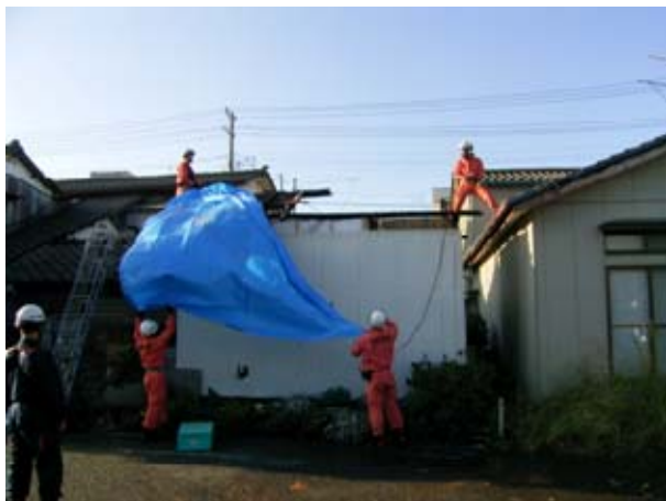
①トタン屋根剥離 (南東から撮影)
