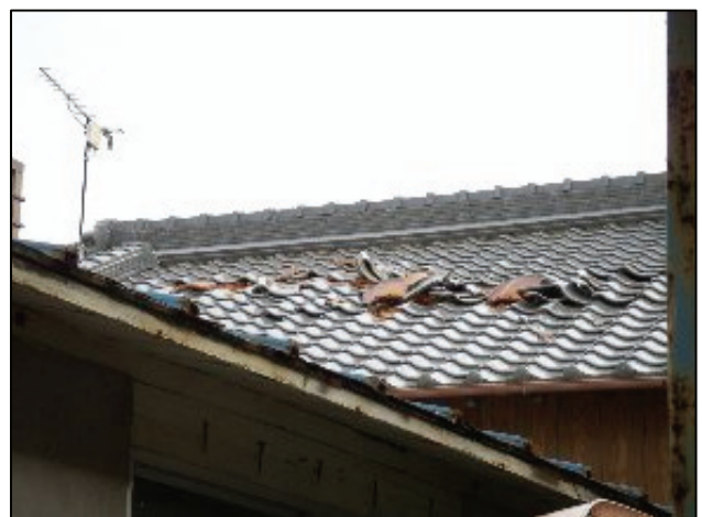
⑥ 住家屋根瓦のめくれ（北西から撮影）
