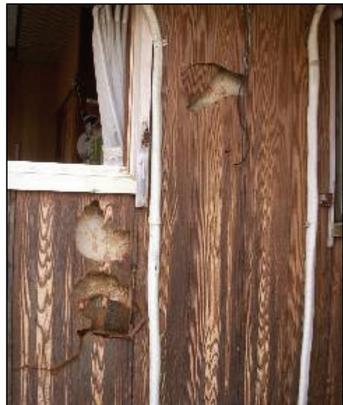
④ 複数の屋根瓦飛散による住家壁面の損傷（東から撮影）
