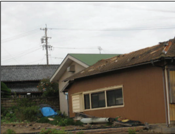
① 住家屋根瓦の飛散（南西から撮影）
