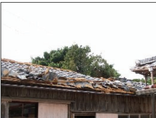
⑤ 住家屋根瓦の破損（東から撮影）
