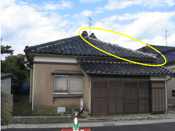
① 瓦屋根の一部落下 (南から撮影)
