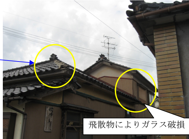
② 瓦屋根の被災状況 (南東から撮影)
