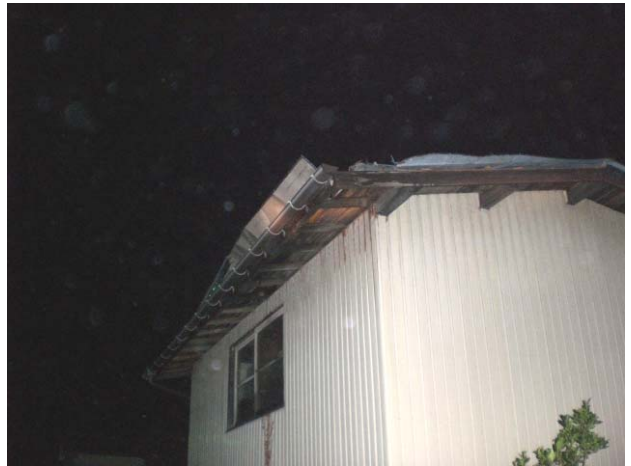
④ 物置のトタン屋根一部損壊
