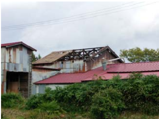
①トタン屋根飛散（南西から撮影）
