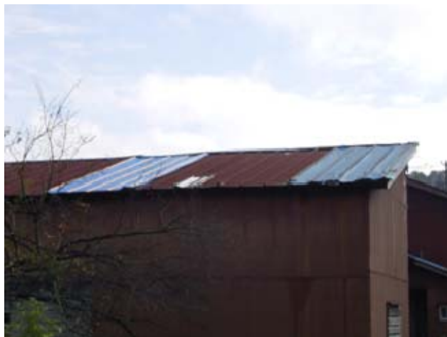
②トタン屋根の破損（北から撮影）
