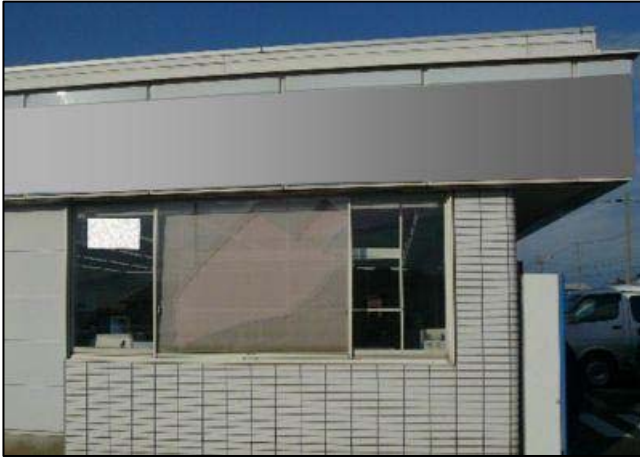
① 破損した商店南側の窓ガラス【南から撮影】
