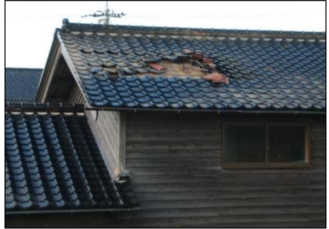
② 非住家の屋根瓦のめくれ【南から撮影】 瓦数枚は東側の田(10~15m)まで飛ばされた。
