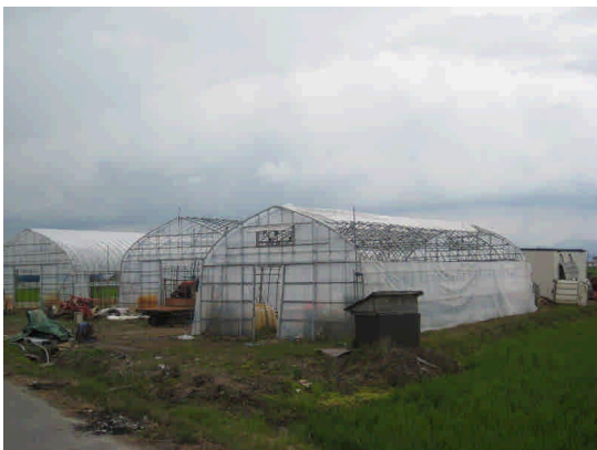
写真 20 農業用ハウスのビニールが南側の 2棟で剥離
