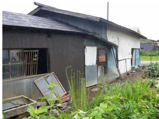
写真12 物置の南側が破損
