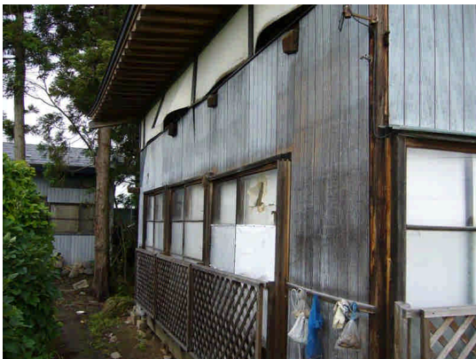
写真 14 民家南側の壁と窓ガラスが破損
