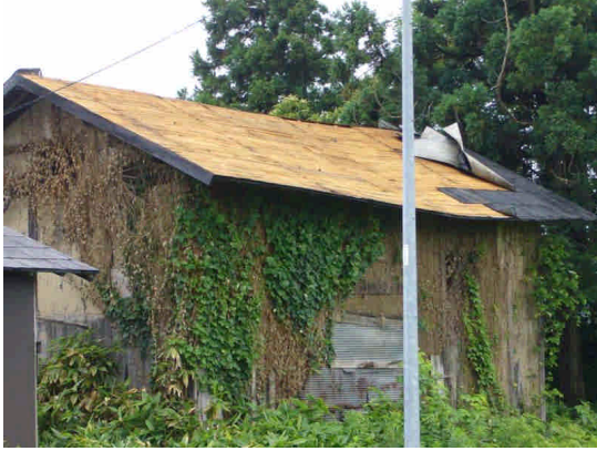
写真07 納屋北側の屋根トタンが南東に飛散
