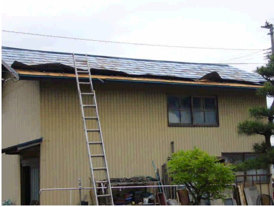
写真 18 納屋の屋根、南側のトタンが剥離
