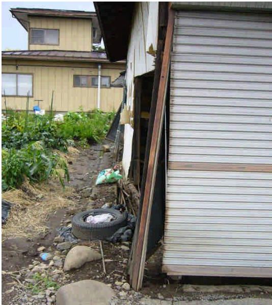
写真 13 車庫の南側破損、シャッターが北にずれる
