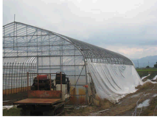
写真 21 農業用ハウスのビニールが剥離
