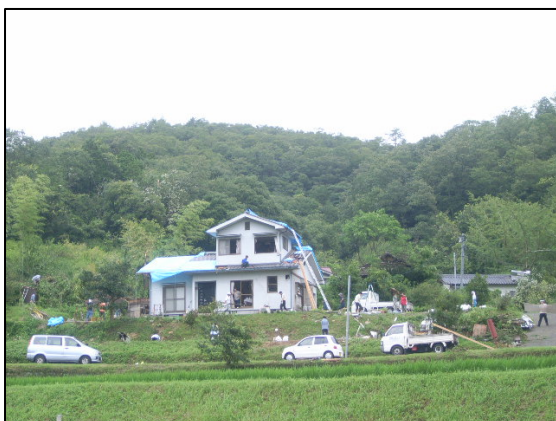
写真① 民家の屋根が損壊
