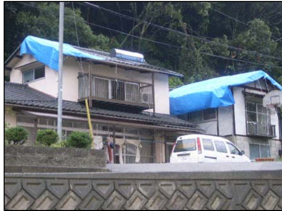
写真④ 屋根が一部損壊
