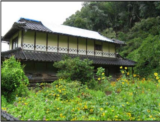
写真① 屋根が一部損壊
