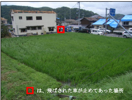
写真⑧ 屋根が全て飛ばされた民家など
