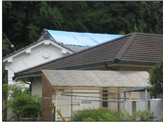
写真② 屋根が一部損壊
