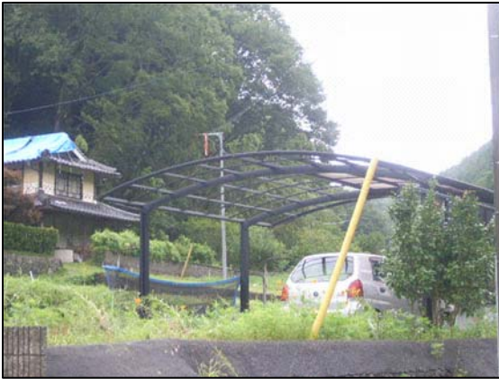
写真③ 車庫の屋根が損壊
