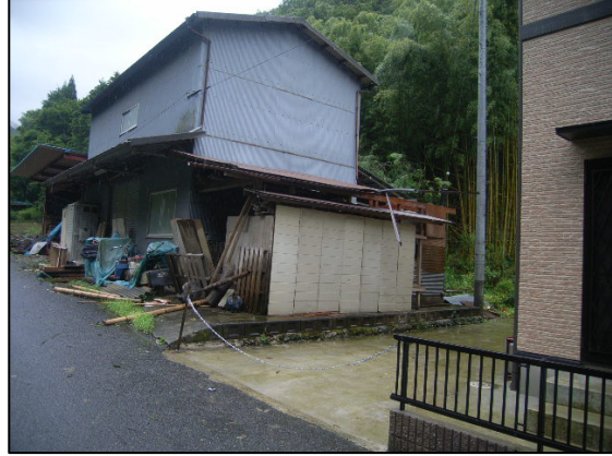
写真② 物置の屋根破損
