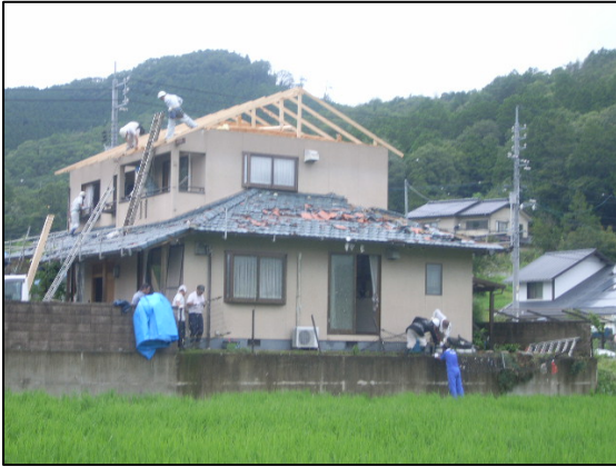
写真④ 民家の2階の屋根が全て飛散
