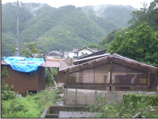
写真① 物置の屋根破損
