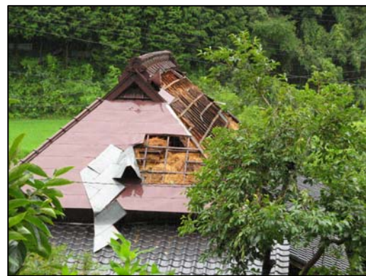
写真② 屋根が一部損壊
