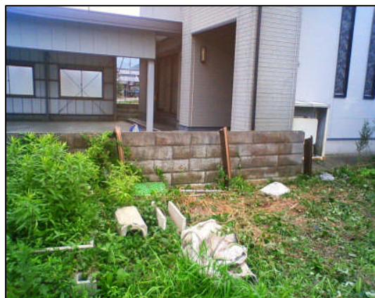
② 丹波市青垣町佐治地区 カーポート支柱とブロック塀（北西にむかって撮影、以下同様に方向を記載）
