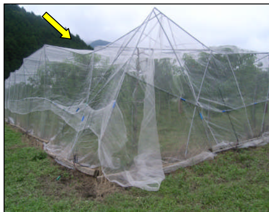
⑥ 丹波市青垣町小倉地区 桃園防蛾ネット支柱の破損状況(北) 矢印 折れ曲がった支柱
