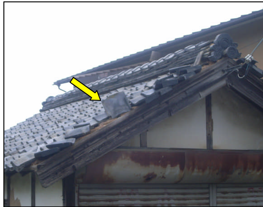
④ 丹波市青垣町小倉地区 消防倉庫屋根の被害状況（北東）
