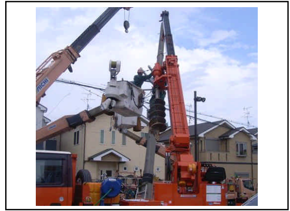
② 宇治市五ヶ庄野添 風に飛ばされた屋根が電線に架かり、電信柱が南東へ倒れる（復旧作業中）。
