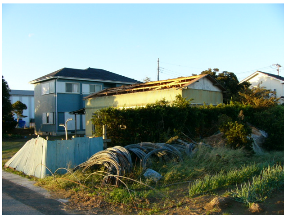
⑤ トタン屋根の飛散（南南東から撮影）
