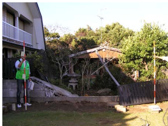
④ 住家のブロック塀倒壊（南西から撮影）
