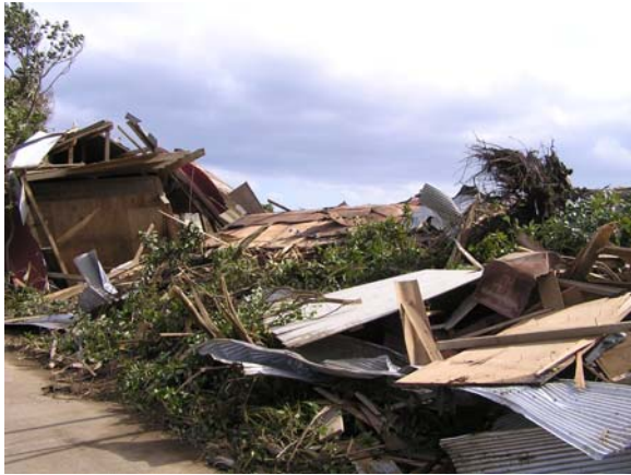
① 非住家の全壊（北西から撮影）
