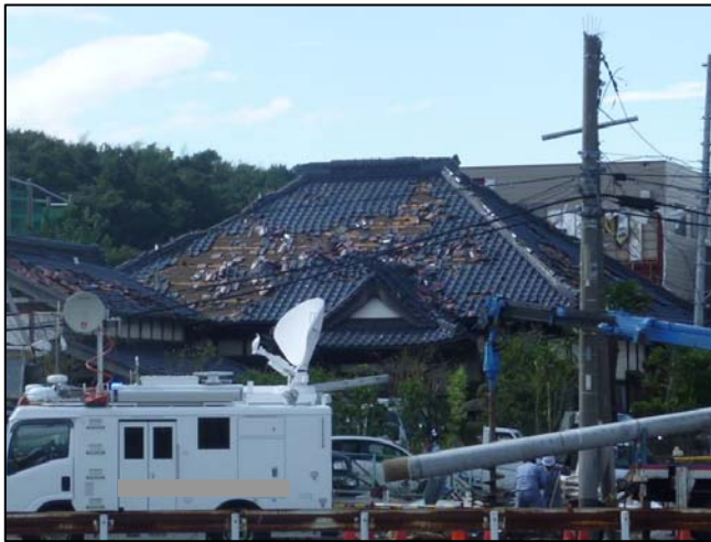
① 住居の屋根瓦の剥離 （南から撮影）
