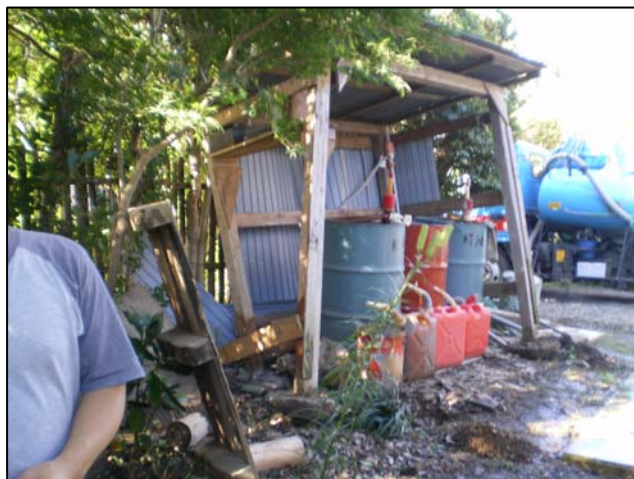
② 基礎が浮き、柱がねじれた燃料小屋 （南から撮影）
