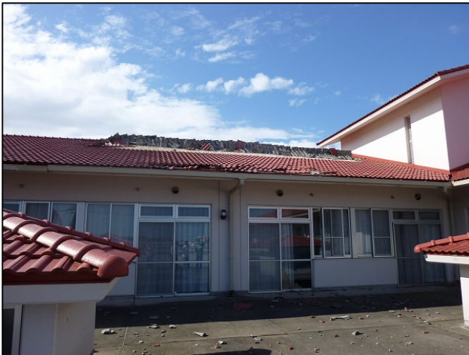
③ 住居（老人ホーム）の屋根瓦飛散 （南東から撮影）
