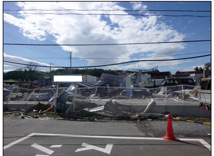
② 木造店舗倒壊とフェンスの倒れ （北西から撮影）
