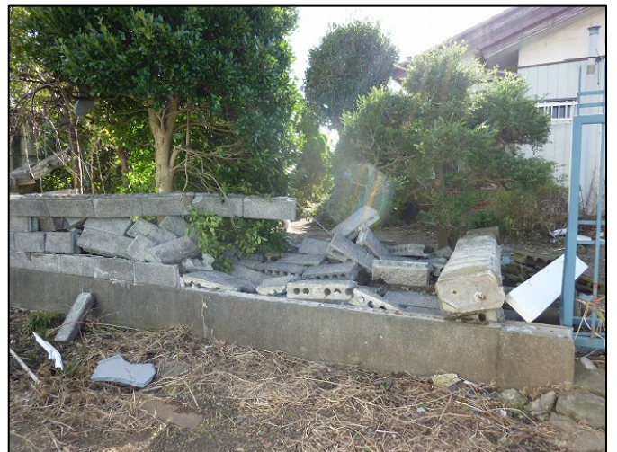
⑥ ブロック塀の崩れ （北東から撮影）
