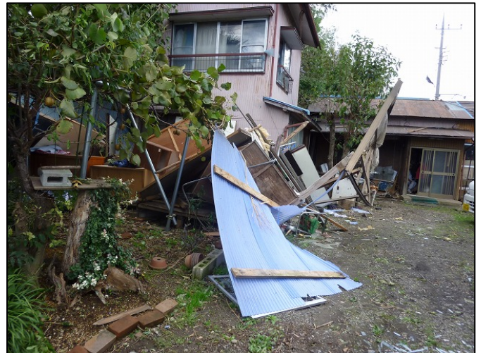
④ 木造住居の破損 （南から撮影）
