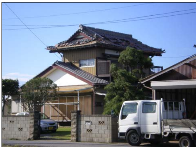
① 住居の屋根瓦の飛散 （南東から撮影）
