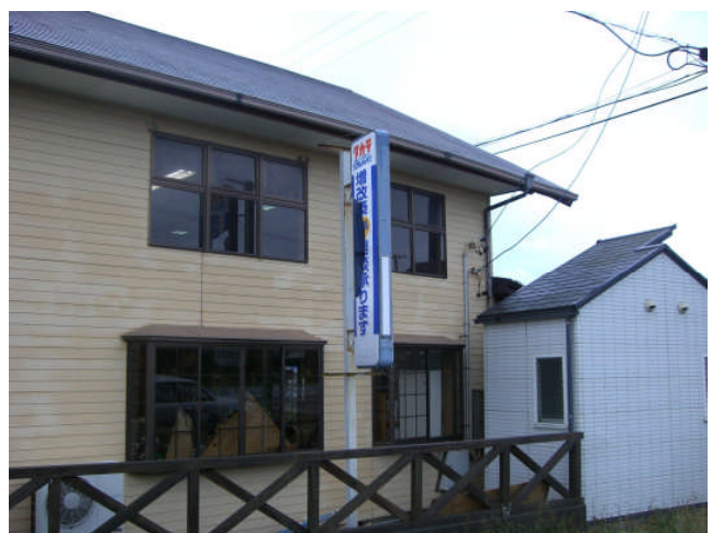
② 事務所看板の一部破損
