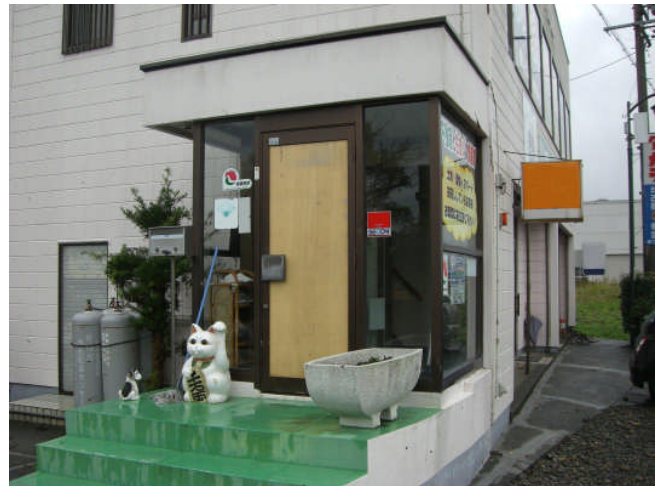
④ 事務所玄関ドアガラスが破損 (ベニヤ板で修復後)
