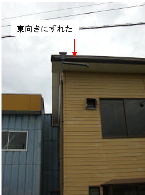
① 破損した雨どい
