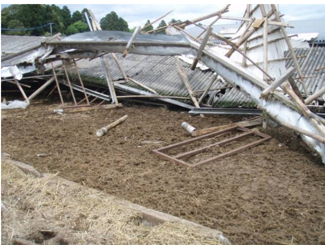
③倒壊した牛舎（南から撮影）
