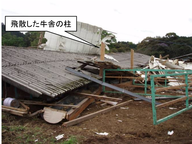
⑦ 飛散した牛舎跡地 (東から撮影)
