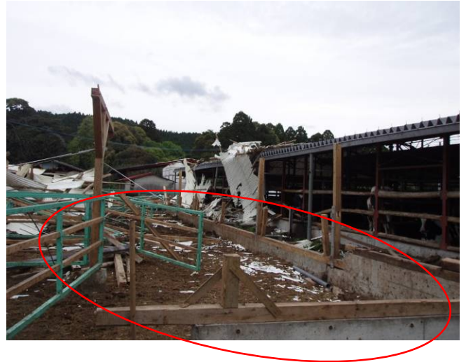
赤丸は飛散した牛舎の基礎部分
