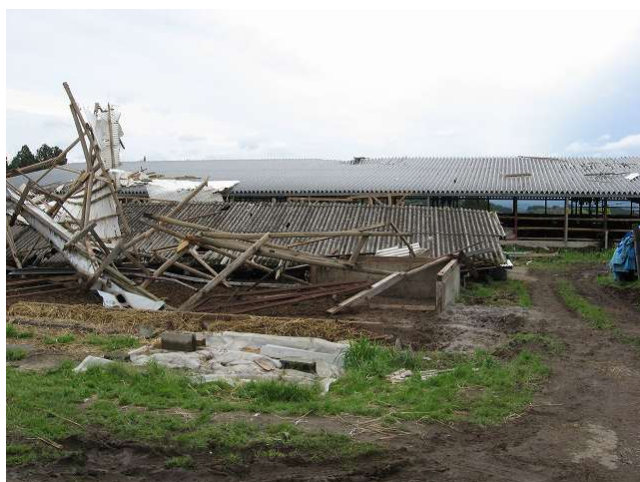
②倒壊した牛舎（南西から撮影）
