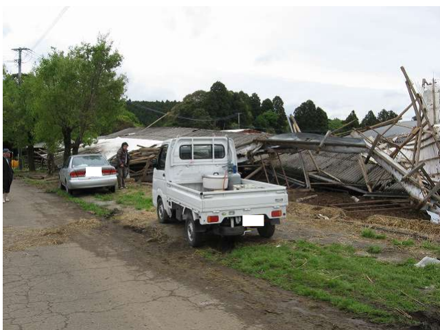
①倒壊した牛舎（南から撮影）
