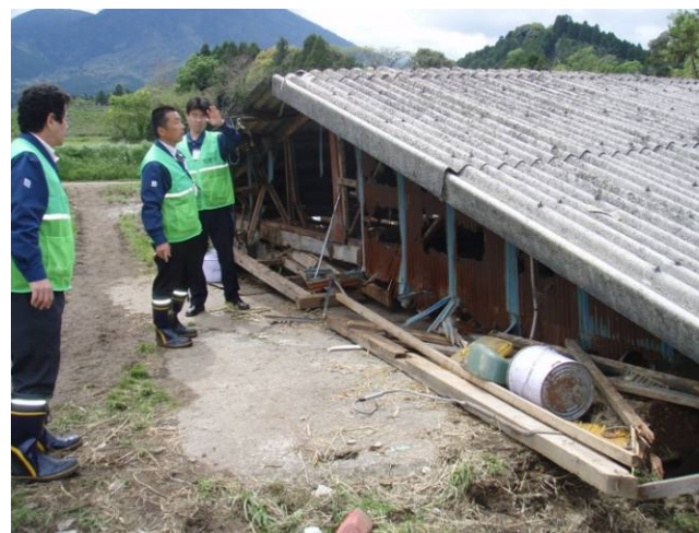
⑥倒壊した牛舎（東から撮影）
