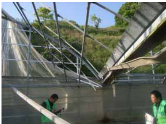
図 8-1 写真の撮影場所 ビニールハウス内部の状況。強固な鉄骨が曲がり、ビニールも捲れていた。
