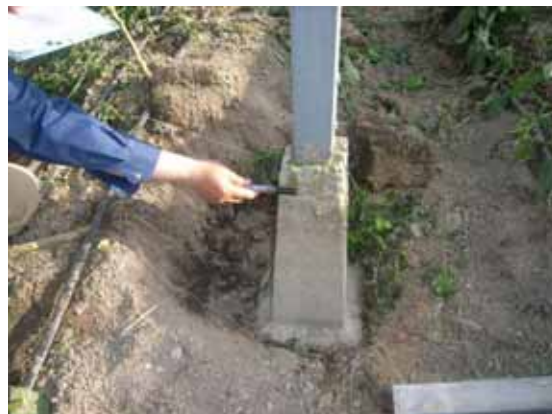
図 8-2 写真の撮影場所 ビニールハウス内部の状況。鉄骨の土台はペンで示した深さまで地中に埋められていたが、完全に浮き上がって露出していた。
