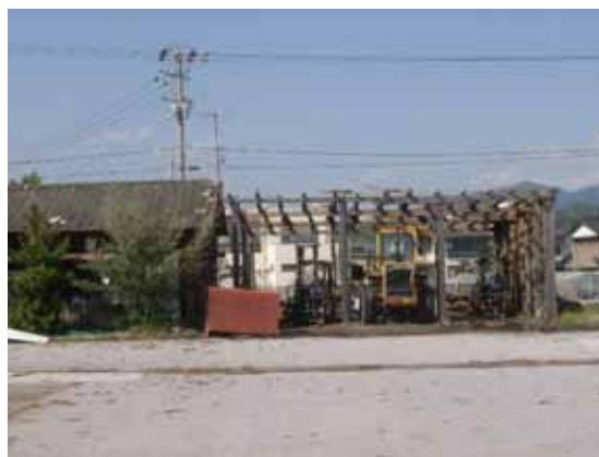
図 9-2 写真の撮影場所 木造車庫のトタン屋根が北側へ吹き飛ばされている。
