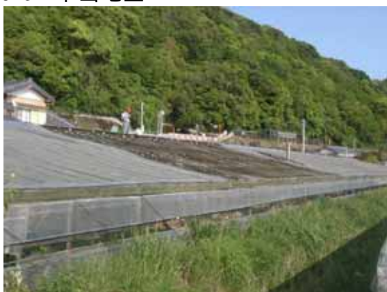
図 10 写真の撮影場所 ビニールハウスの南西側ビニールが捲れている。
