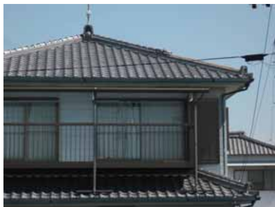
図 9-3 写真の撮影場所 南東の瓦が捲れている。 (写真：安芸市役所提供)
