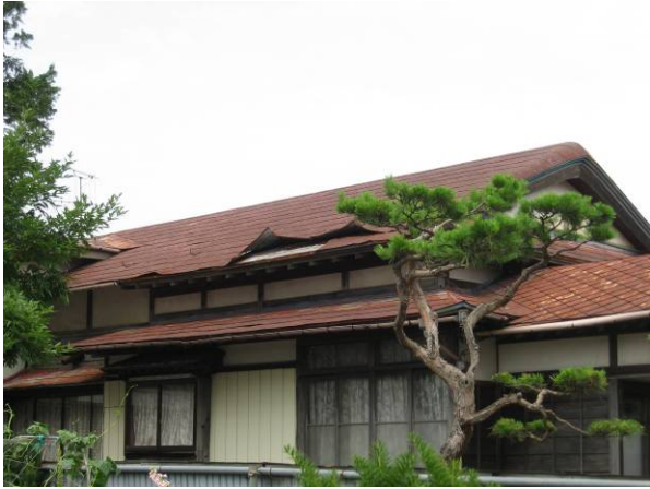
⑨ 非住家屋根の剥離（南西から撮影）
