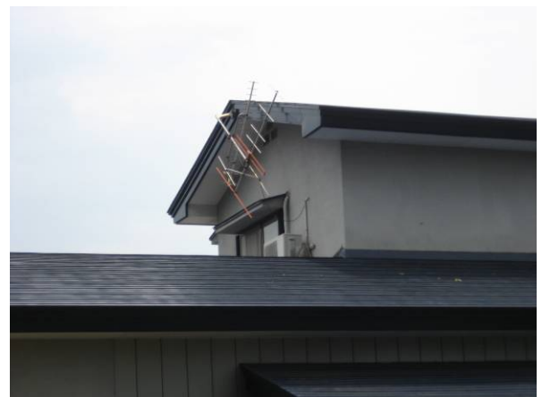
⑧ 倒れたテレビアンテナ (東から撮影)
