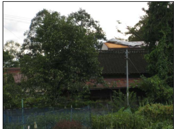
⑫ 破損したトタン屋根 (東から撮影)
