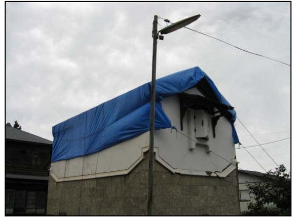
② 屋根が飛んだ蔵 (南西から撮影)
