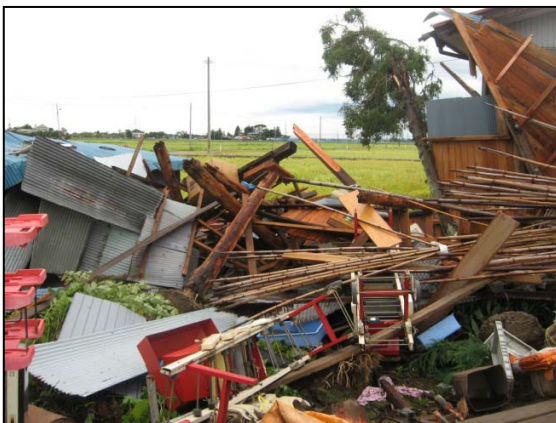
⑤ 倒壊し飛散した倉庫 (南西から撮影)
