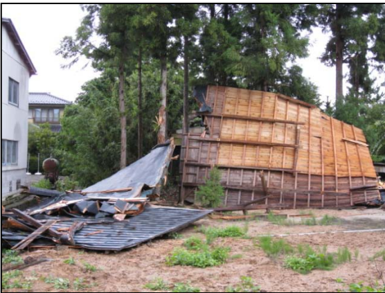
③ ②の蔵から飛んだ屋根 (南から撮影)
