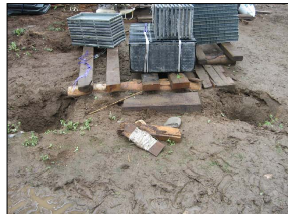
⑥ ⑤の倒壊し飛散した倉庫の土台跡 (南西から撮影)
