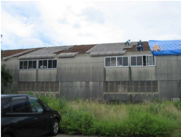
⑪屋根が飛散した倉庫 (南西方向から撮影)
