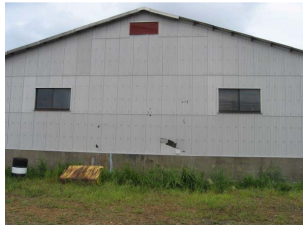
⑭飛散物により破損した外壁 (南方向から撮影)
