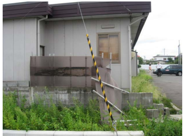
⑥倒れたブロック塀 (⑤写真○印拡大) (北方向から撮影)
