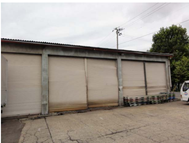
⑬破損したシャッター (南東方向から撮影)
