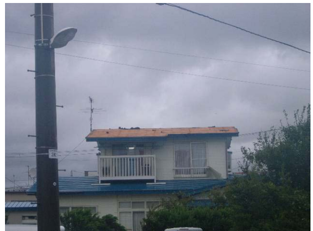
②屋根が飛散した住宅 (土崎消防署提供：南方向から撮影)
