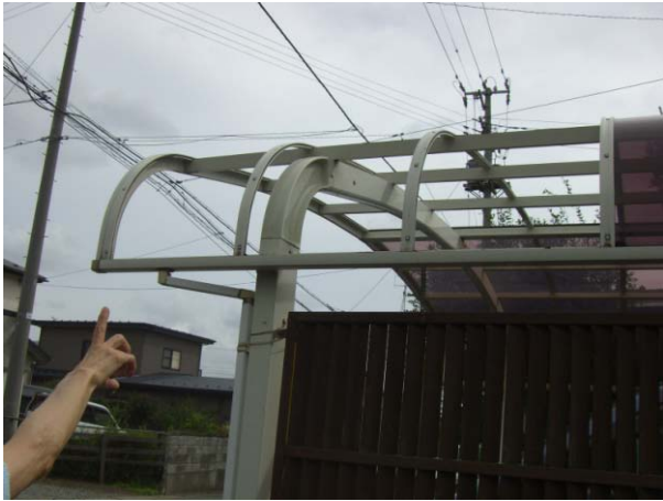
⑨屋根が飛散したカーポート (北方向から撮影)
