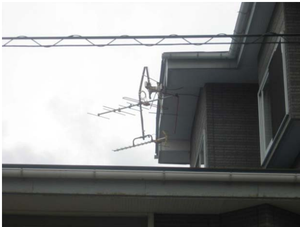
③東方向へ倒れたアンテナ (北から撮影)
