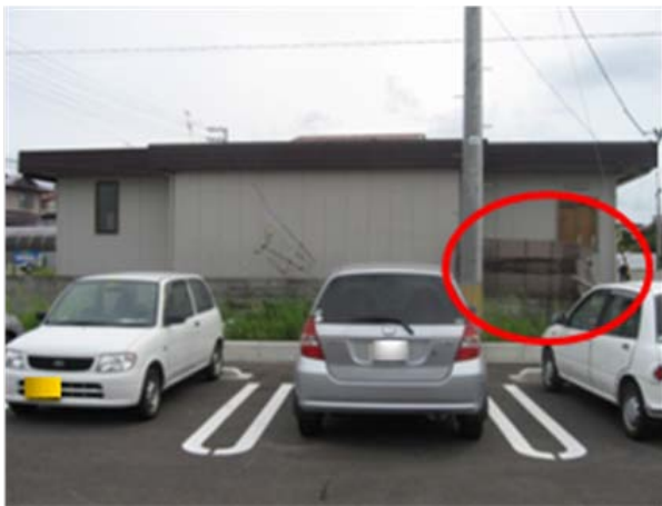
⑤落下したアンテナと倒れたブロック塀 (北方向から撮影)
