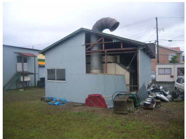
④剥離した外壁 (土崎消防署提供：南東方向から撮影)
