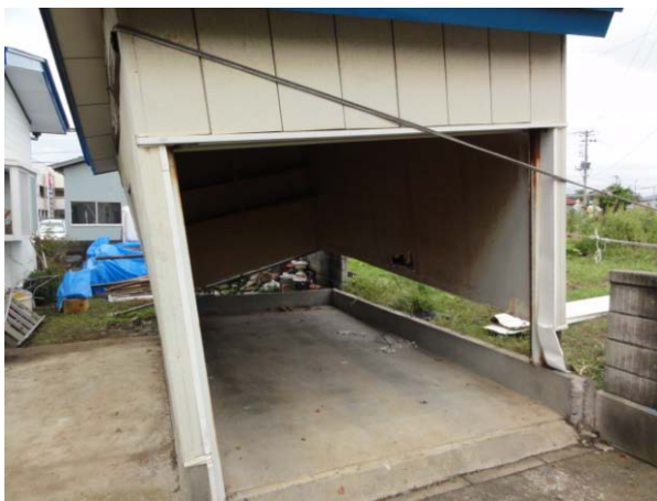
①西方向へ傾いた車庫 (南方向から撮影)
