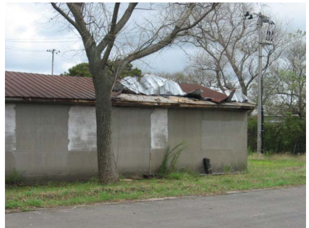
⑫剥離した屋根 (西方向から撮影)
