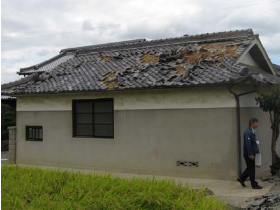
図 7-12 写真撮影場所⑫ 捲れ上がった屋根瓦。瓦の一部分が飛散した。
