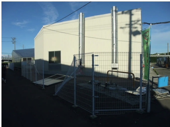
⑦ 破損したフェンス
