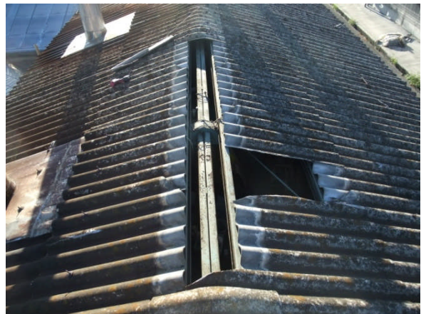
⑧ 破損したスレート屋根
