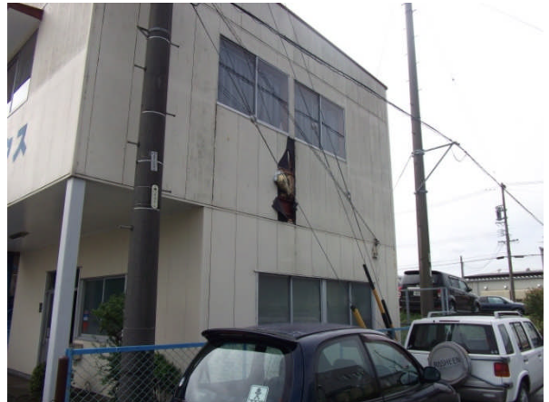
⑥ 外壁の一部破損
