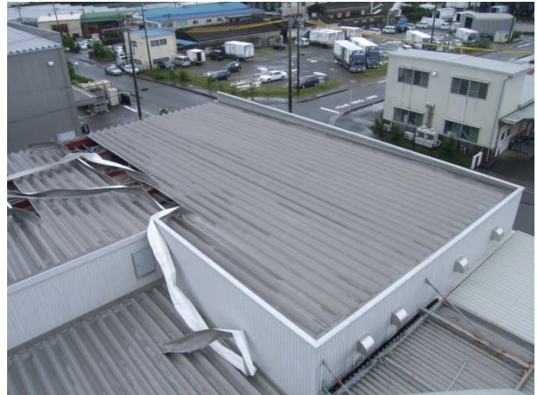
④ 屋根が剥離
