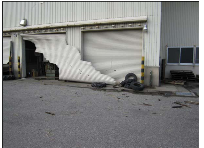
④ 捲れたシャッター (東北東から撮影)
