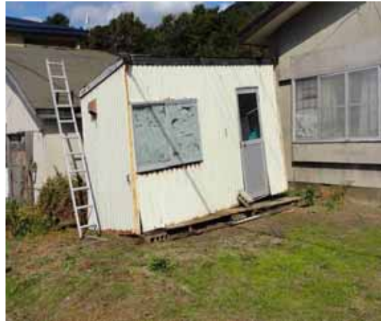
北西側にずれて傾いた物置小屋 (南から撮影)
