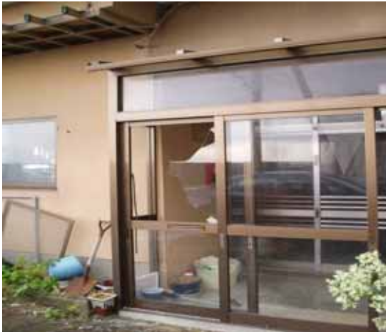
玄関の窓ガラスが割れた住家 (八峰消防署提供：東から撮影)
