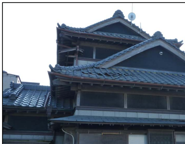
⑦ずれた屋根瓦
