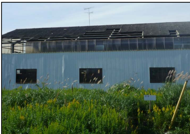
⑤剥がれた倉庫の屋根
