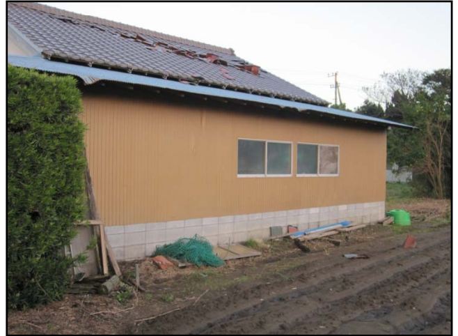
②屋根から剥がれて落下した瓦
