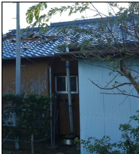
⑥剥がれた屋根瓦
