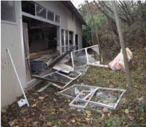
北側に飛ばされた倉庫の窓ガラス (八峰町役場提供：東から撮影)
