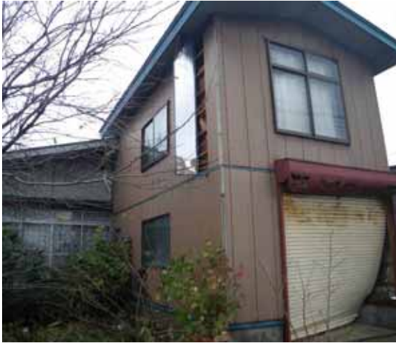
外壁の剥離とシャッターが破損した非住家 (八峰町役場提供：南西から撮影)
