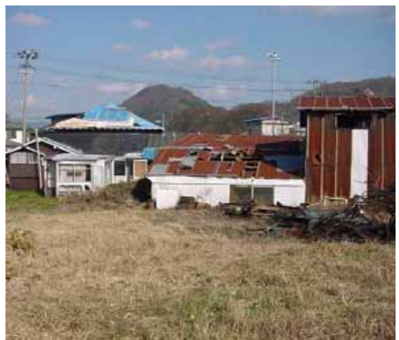
屋根のトタンが飛散した住家と物置 (南西から撮影)
