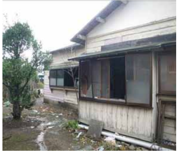
東側に散乱した空き家の窓ガラス (八峰町役場提供：北東から撮影)
