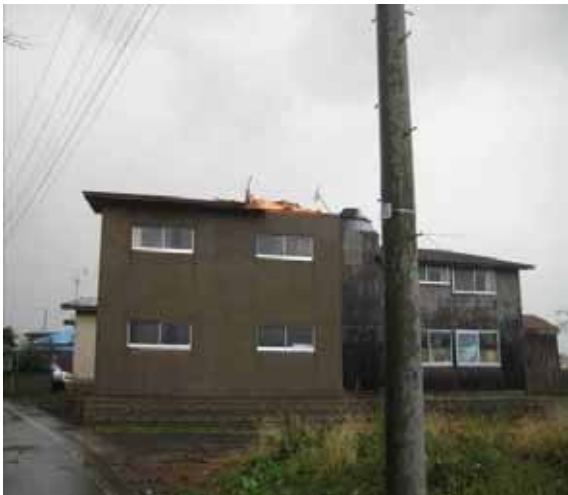
屋根のトタンが飛散した住家 (八峰町役場提供：西から撮影)
