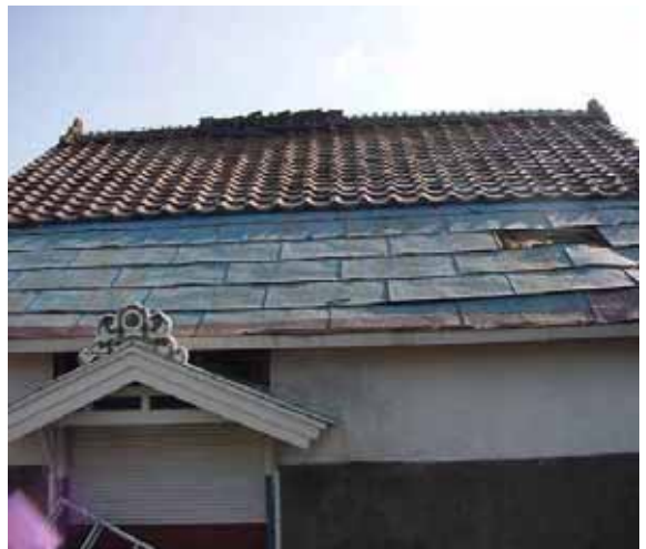
屋根瓦が東側に剥離した蔵 (西から撮影)
