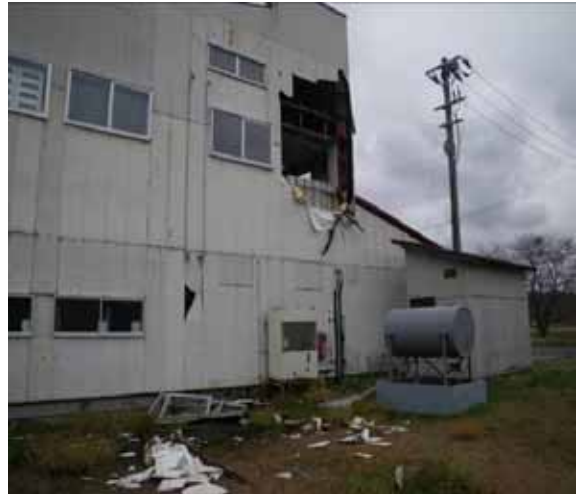
西側に散乱した事務所の窓ガラスと外壁 (八峰町役場提供：北西から撮影)
