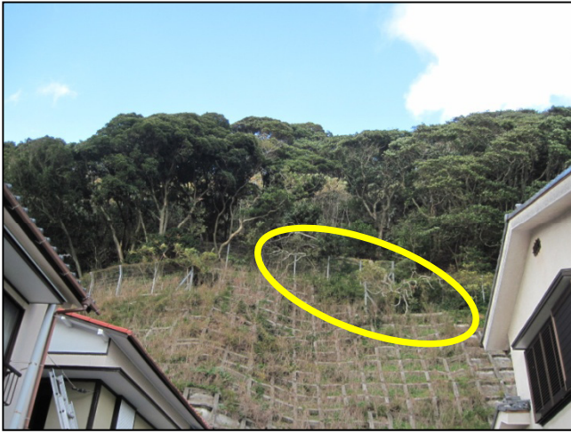
④崖上の倒木 (黄色の線で囲んだところが倒木)
