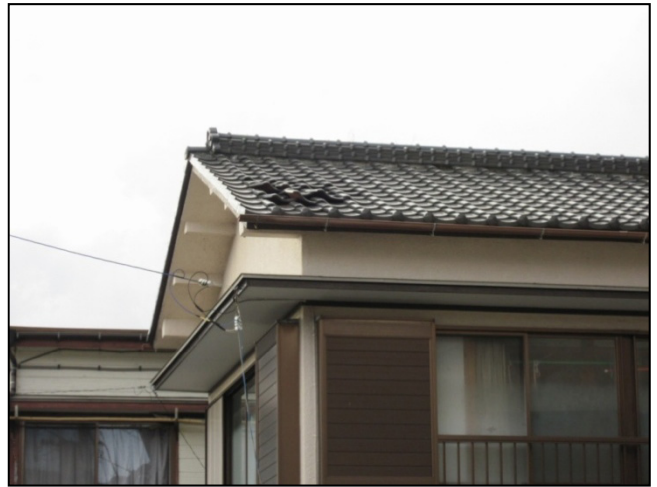
⑦屋根瓦の被害
