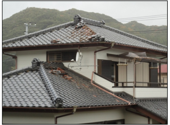
②屋根から剥がれて落下した瓦
