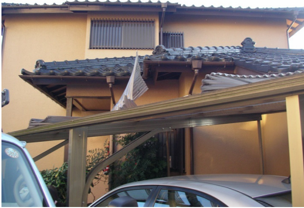
① 破損した車庫（北から撮影）
