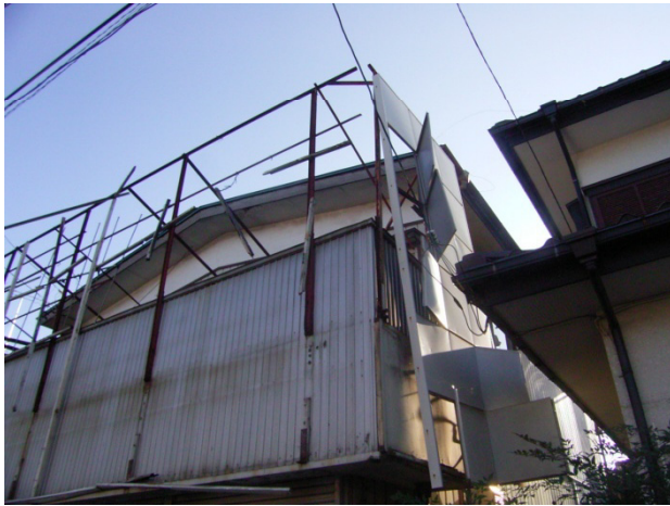
③ 看板（トタン）の破損（北から撮影）
