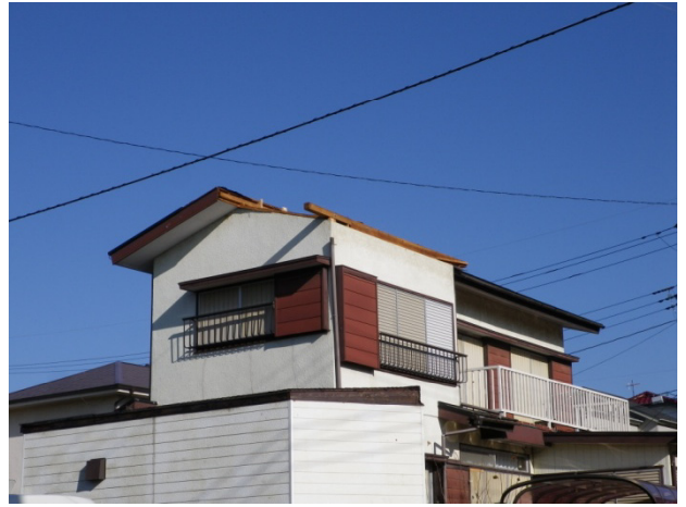
④ 屋根の一部破損（南西から撮影）
