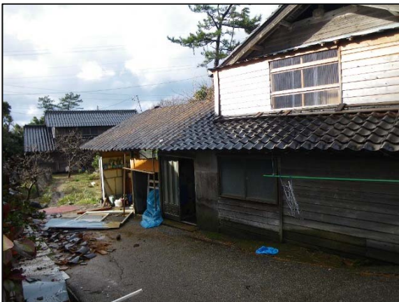
③屋根瓦が落下、飛散した納屋 【南東から撮影】
