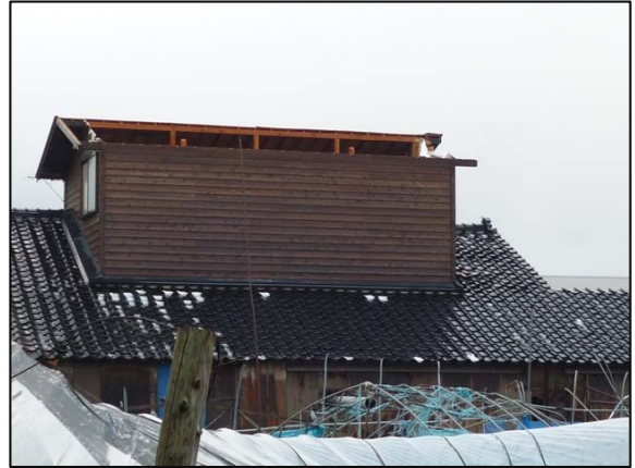
⑧屋根の片側が飛ばされた工場 【西から撮影】
