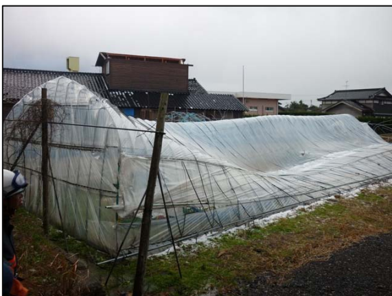
⑤潰れたビニールハウス 【北西から撮影】
