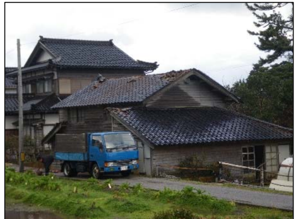
④屋根瓦が落下、飛散した納屋 【北東から撮影】
