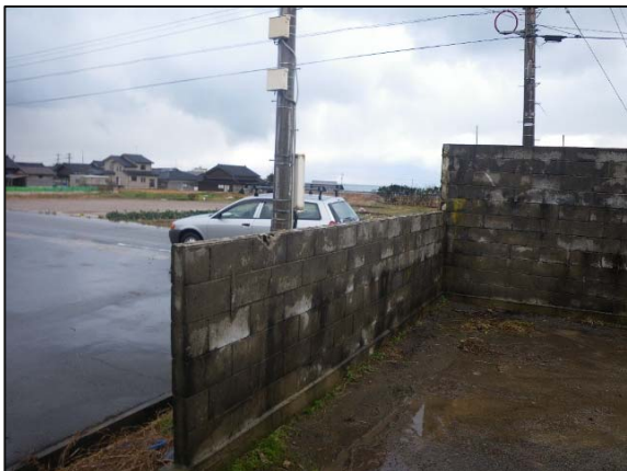
⑪上部が損壊したブロック塀 【東から撮影】
