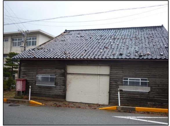
⑥西面の屋根瓦が捲れた倉庫 【南から撮影】
