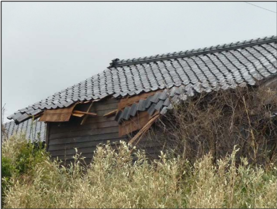
①屋根瓦の一部破損、落下した非住家 【南西から撮影】
