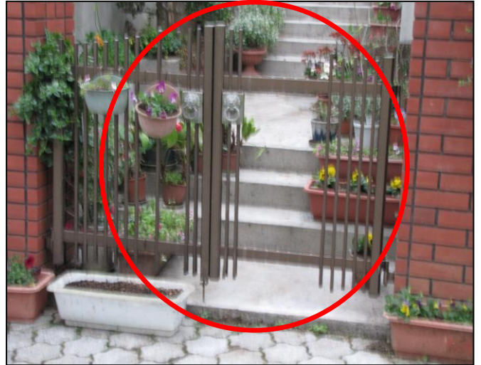
⑥ 門扉の破損（片づけ後撮影） ○：破損した門扉
