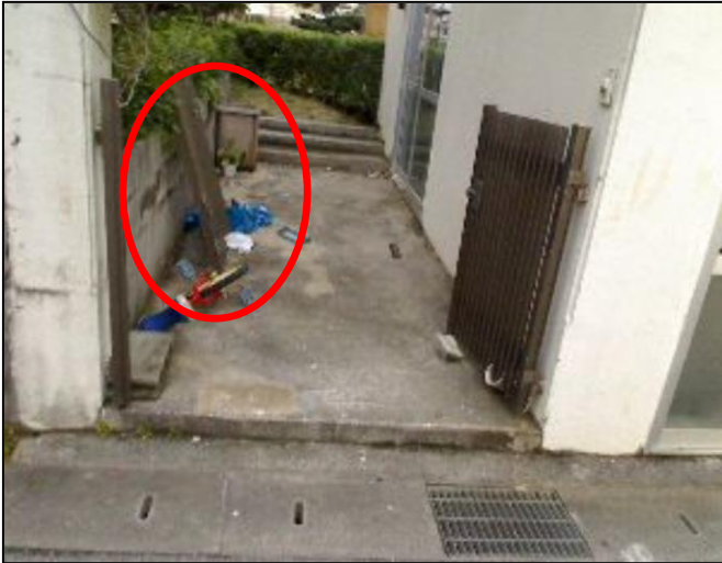
⑤ 門扉の破損 北側に飛散（片づけ後撮影） ○：飛散した門扉
