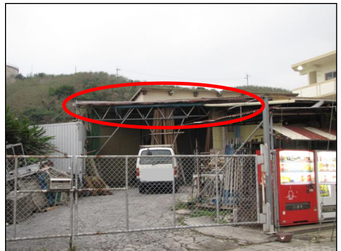
④ 工場のトタン屋根 一部剥離 (修復後撮影) ○：剥離したトタン屋根
