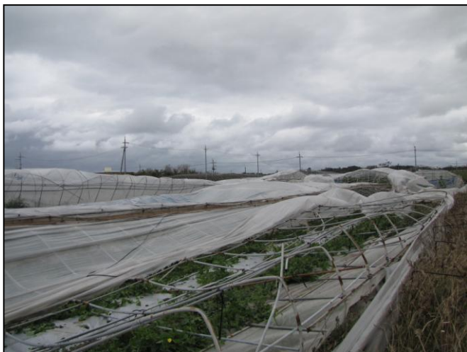
③ ビニールハウス5棟 損壊
