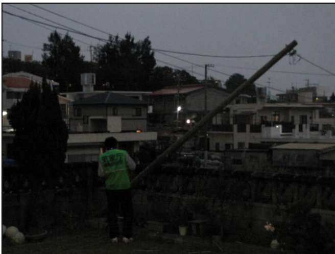
① 木製の電柱 南側に傾く
