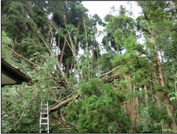
① 家屋方向に幹折れした杉の木 (南西から撮影)
